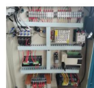
Machine control center 机器控制中心
