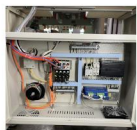
Machine control center 机器控制中心
