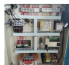
Machine control center 机器控制中心
