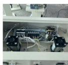
Machine control panel 机器控制面板
