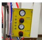
Machine control panel 机器控制面板
